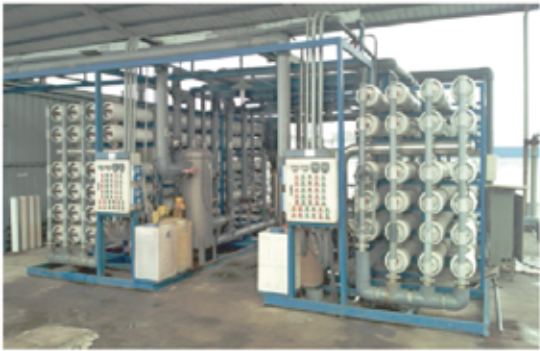
② 绍兴某公司2300T/D中水回用项目
